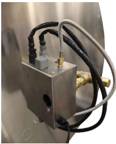
Foto 12: Conexión del conducto de gas del piloto a la válvula
