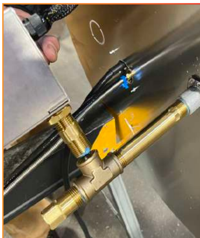
Foto 9: Fijación de la caja de válvulas a la pierna de goteo
